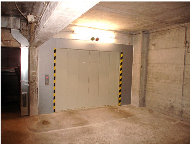
Foto Nr. 3: Pkw-Aufzug
